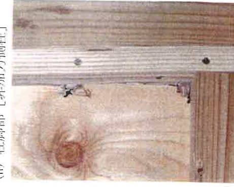
(k) 面材 (たて枠接合くぎ位置) の引き裂き
