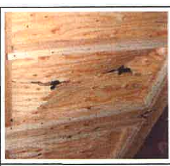
④: 面材の破断
