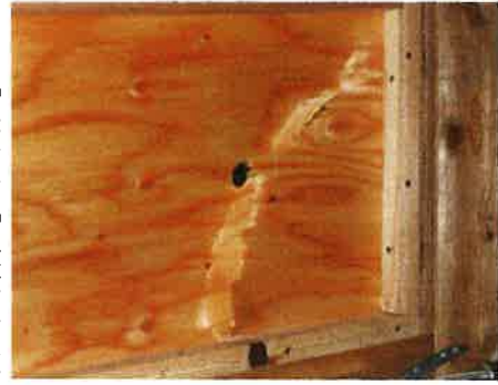
(i) 面材の座屈
