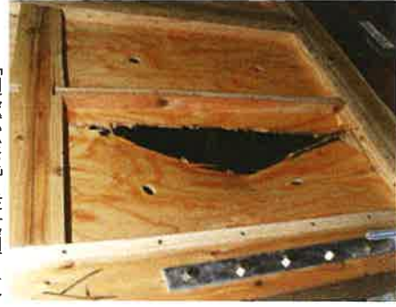
(i) 面材の座屈
