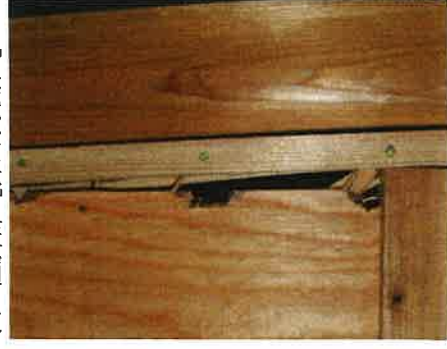
(k) 面材 (たて枠接合くぎ位置) の引き裂き
