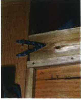
(e) 柱頭部 [非加力側柱]
