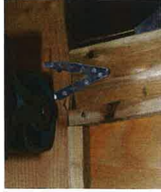
(e) 柱頭部 [非加力側柱]
