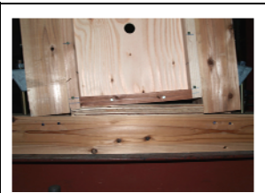
①: パネルたて枠および下枠の浮き上がり
